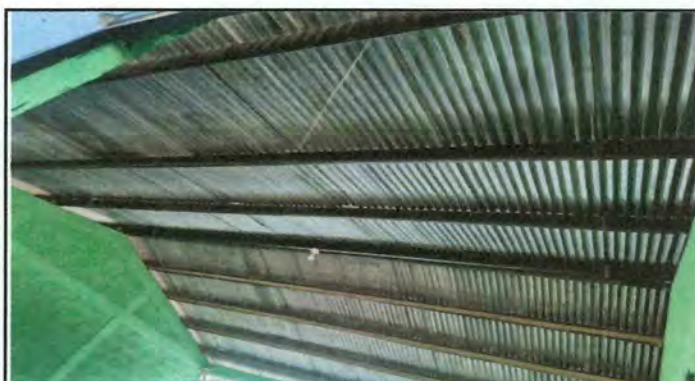
Foto 4: Las costaneras están corroídas de óxido debido a la filtración de agua de lluvia y se han deteriorado demasiado.
