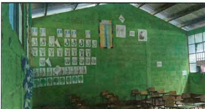
Foto 5: Las paredes de las aulas están manchadas y la pintura ya no tiene la misma consistencia luego de 4 años de no pintarse en el interior de las aulas.
