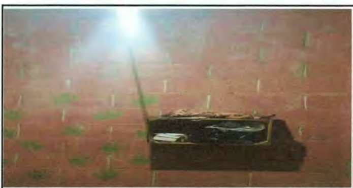
Foto 6: Varía los colores en el interior de las aulas de la escuela, debido a la carencia de pintura y la falta de recurso para sufragar la pintada completa en el interior.
