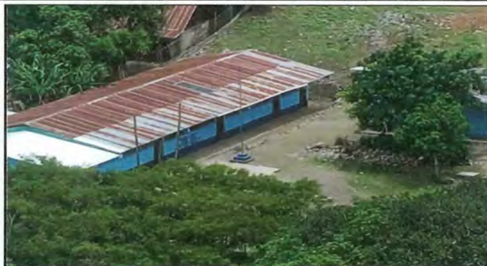
Foto 1: Las láminas se encuentran en mal estado generando la filtración de agua en época de lluvia y empozándose dentro de las aulas. Al igual que los canales es necesario mejorarlos.
