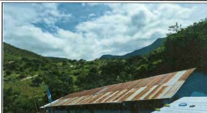
Foto 2: Otro perfil del entechado de las láminas que se pueden observar el deterioro y el tiempo de vida ya caducado del material, donde se filtra el agua de lluvia.
