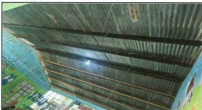
Foto 3: Las costaneras están corroídas debido a la filtración de agua de lluvia
